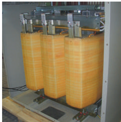
400 кВА с алюминиевыми обмотками
